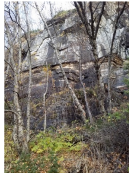
Bilde 12: Svak bergartslag kan sees i lagdelingen i bergflog, her like øst for vestre påhugg.
