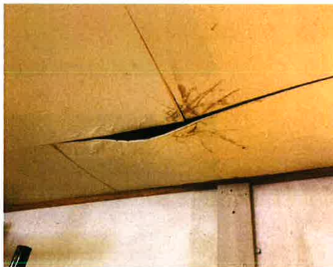
Himling i lagerrom hvor plater er svellet ut over tid. Skader oppstått fra ca 3 år tilbake i tid.
