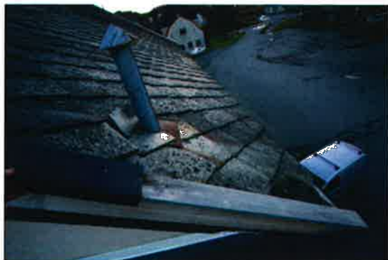
Rustskade på taklyre og manglende vannbordbeslag.
