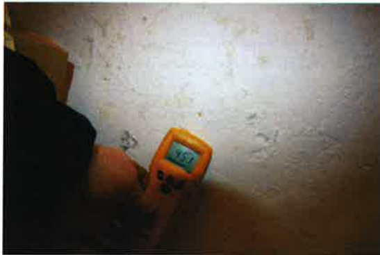
Fuktindikasjon på bakvegger av betong u-etg.
