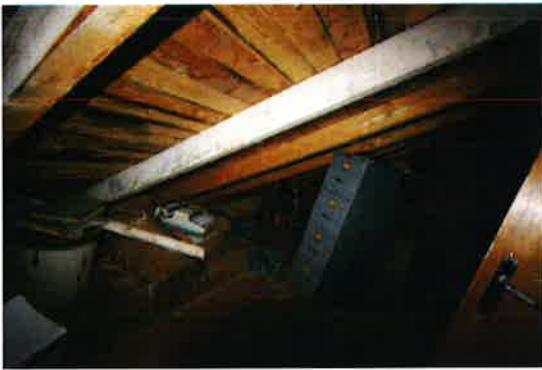
Taktro gamle del m/noe råteskadet taktro.
