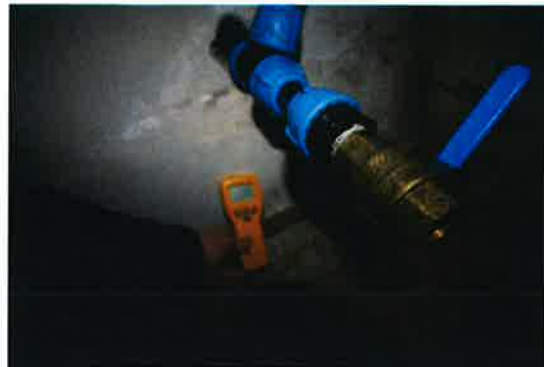
Vanninntak i bakvegg, u-etg.
