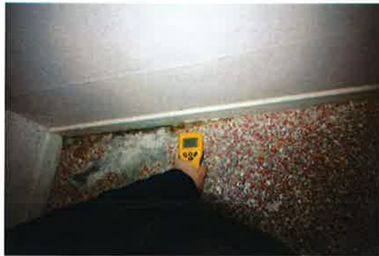
Fuktindikasjon i gulv wc-rom u-etg.
