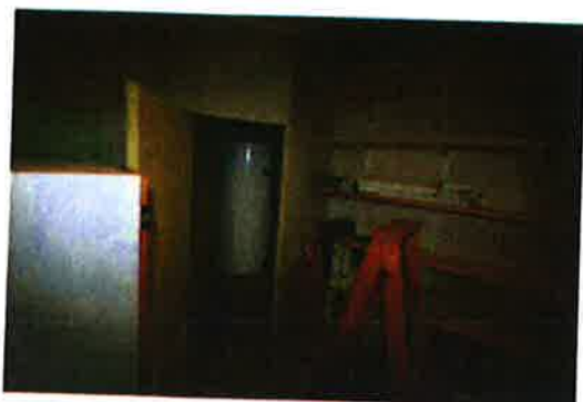
VVT plassert på krakk/bord i kott 3.etg.
