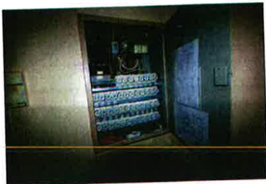
Eksempel 1 på sikringskap, 2. etg.
