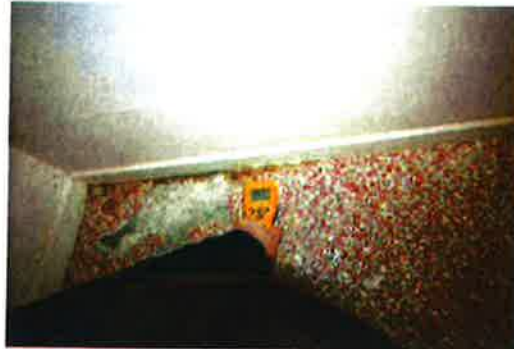
Fuktindikasjon i gulv wc-rom u-etg.
