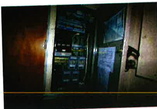
Eksempel 2 på sikringskap, 2. etg.
