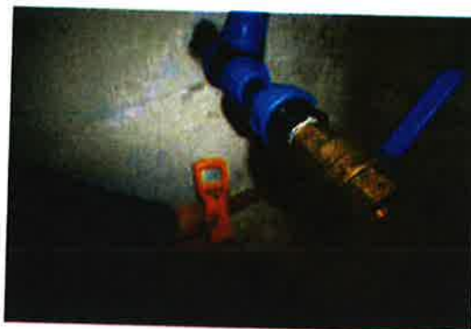
Vanninntak i bakvegg, u-etg.
