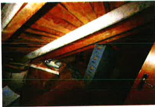
Taktro gamle del m/noe råteskadet taktro.
