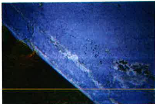
Grunnmursplast Grunnmursplast mangler topplis.
