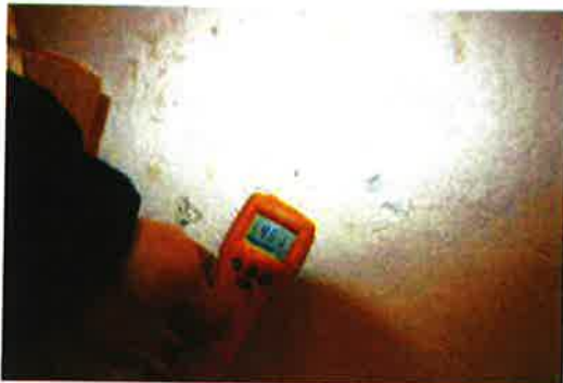
Fuktindikasjon på bakvegger av betong u-etg.
