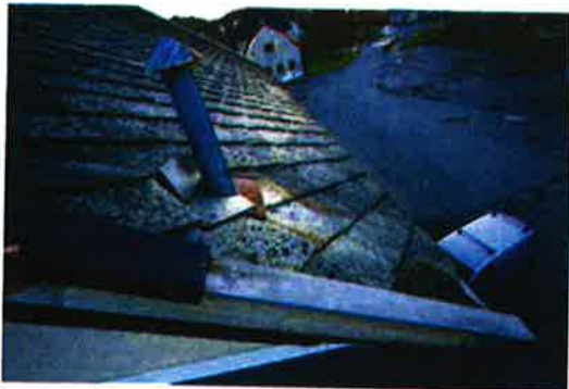
Rustskade på taklyre og manglende vannbordbeslag.
