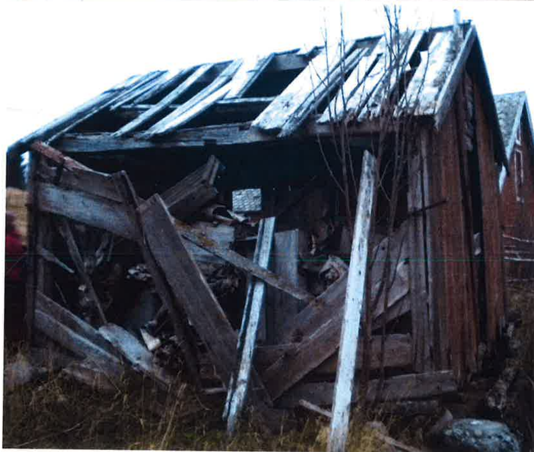
Figur 11 Sjøbuen er i ekstremt dårlig forfatning. Den er nærmest etterlatt til seg selv og tidens tann.
