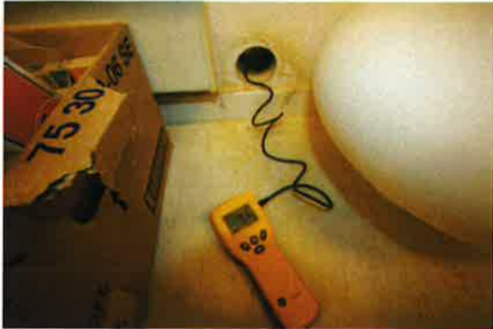
Fuktmåling i innforet bakvegg u-etg.
