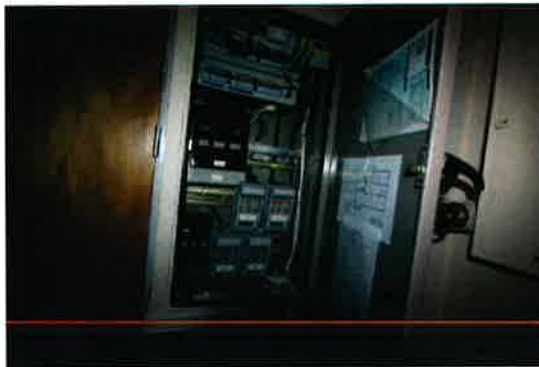
Eksempel 2 på sikringskap, 2. etg.
