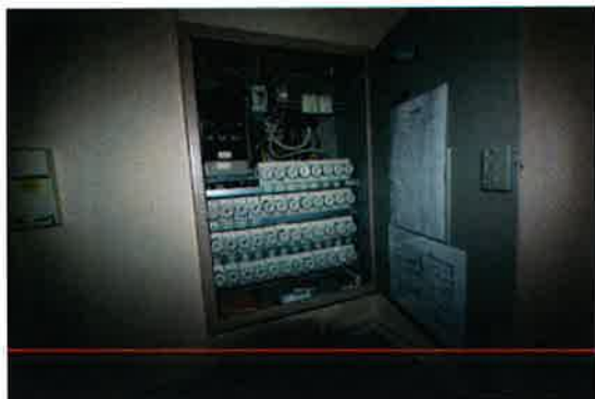
Eksempel 1 på sikringskap, 2. etg.
