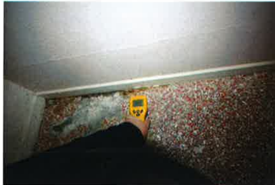
Fuktindikasjon i gulv wc-rom u-etg.
