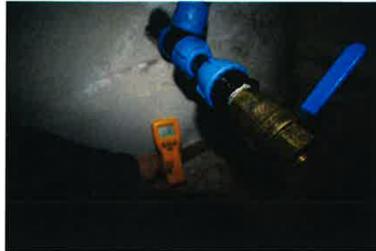
Vanninntak i bakvegg, u-etg.
