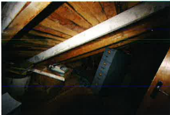
Taktro gamle del m/ noe råteskadet taktro.
