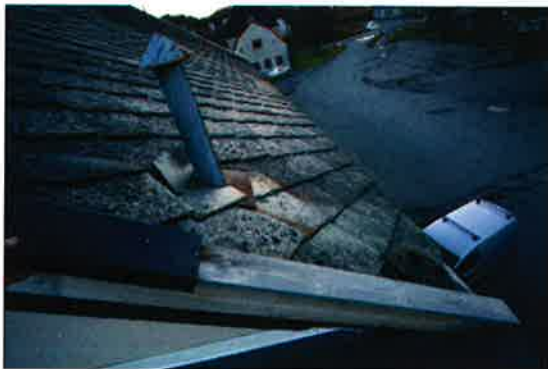
Rustskade på taklyre og manglende vannbordbeslag.
