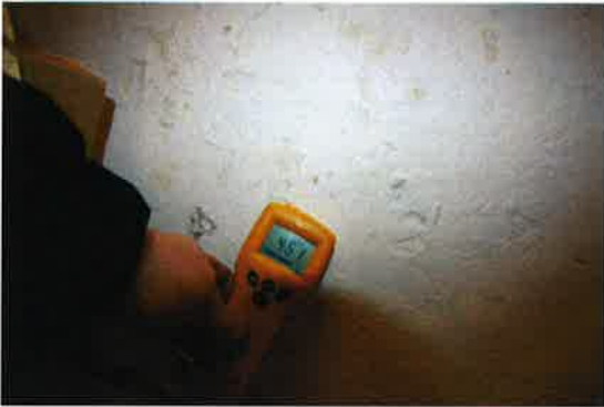
Fuktindikasjon på bakvegger av betong u-etg.
