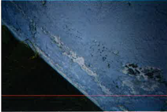
Grunnmursplast Grunnmursplast mangler topplist.
