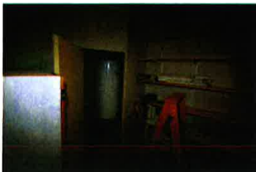
VVT plassert på krakk/bord i kott 3.etg.
