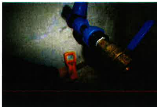
Vanninntak i bakvegg, u-etg.
