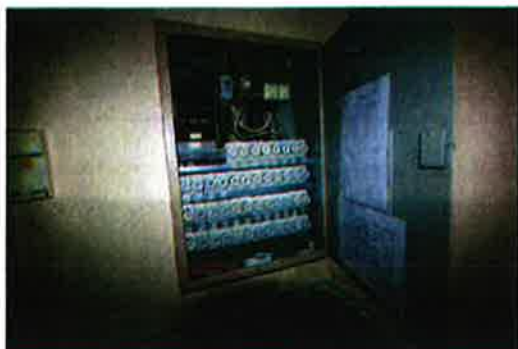
Eksempel 1 på sikringsskap, 2. etg.
