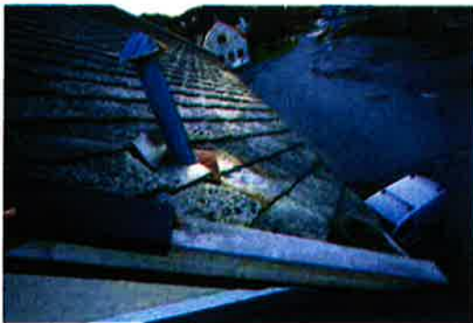
Rustskade på taklyre og manglende vannbordbeslag.
