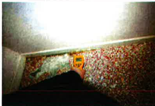
Fuktlindkasjon i gulv wc-rom u-etg.
