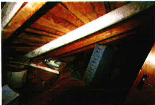
Taktro gamle del m/noe råteskadet taktro.
