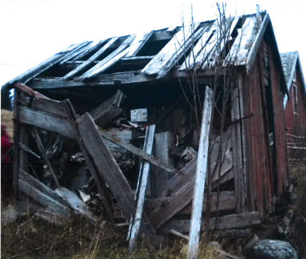
Figur 11 Sjøbuen er i ekstremt dårlig forfatning. Den er nærmest etterlatt til seg selv og tidens tann.
